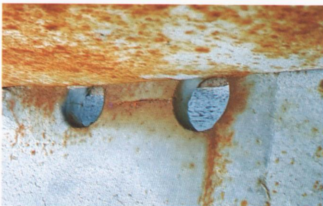
Рис. 7. Дефект, не усунений під час монтажу (кінці тріщини були зупинені методом свердлення), що не набув подальшого розвитку [2]
